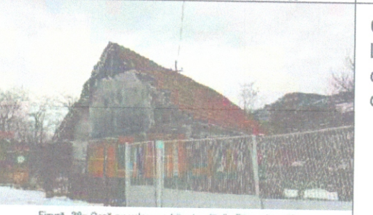
Clădire nr. 69 - Clădire tradițională cu pridvor în L, cu fronton decorat cu elemente structurale de lemn sculptate prezentând traforuri detaliate. Golurile și tâmplăriile sunt alterate.
